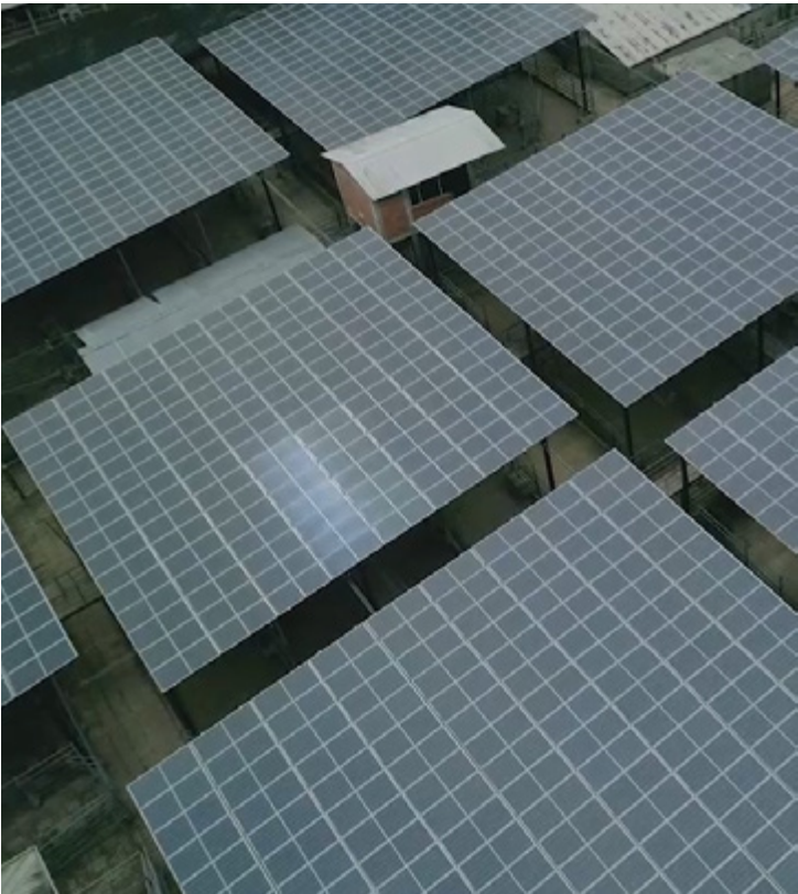
Paneles de energía solar en la unidad industrial de Bucaramanga, Colombia.
